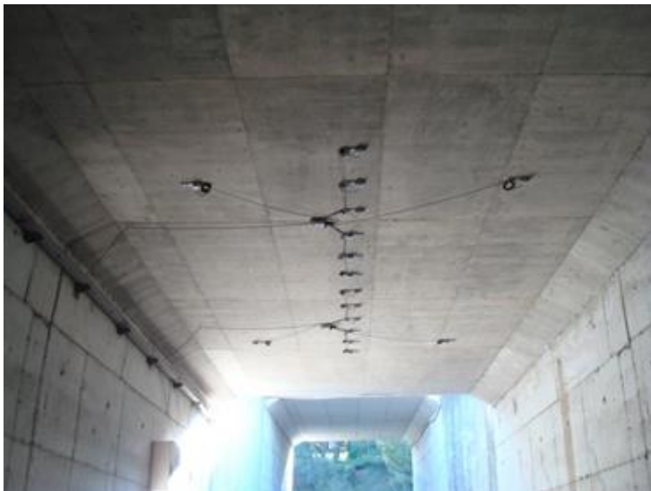
Slika 82: Namestitvev zaznaval na spodnji strani nosilca mostu (slika: © Cestel/SiWIM)
